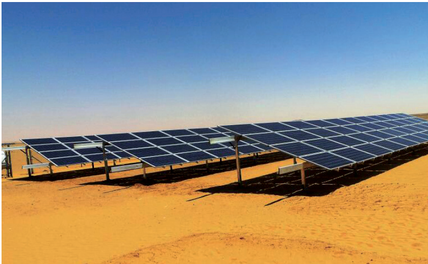
Wüsteninstallationen (bis zu 50 °C)
